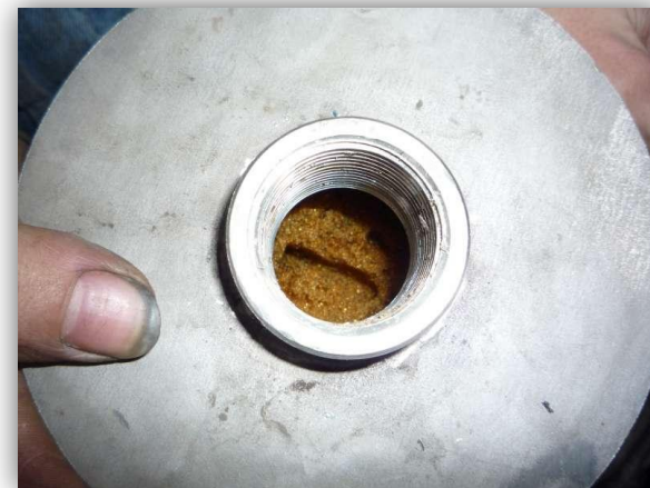
Resina dentro del Tanque de-ionizador
