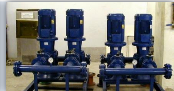
Grupos de bombeo con bombas de emergencia
