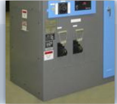
Switch de transferencia manual.
