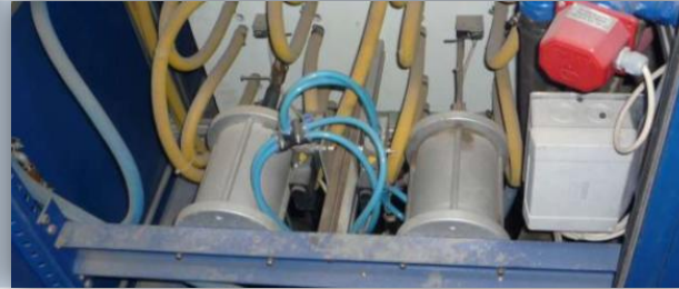
Cilindros neumáticos, dentro del convertidor
