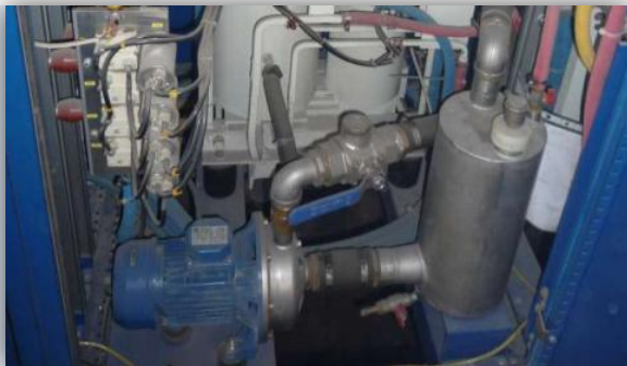
Bomba de circulación, filtro y tanque del circuito interno de refrigeración del convertidor. ( todo está dentro del convertidor)
