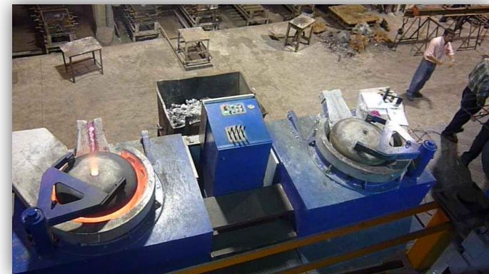
Sistema de 2 hornos con cubículo hidráulico donde se cambia de hornos, además de la basculación, control de temperatura, entre otros.
